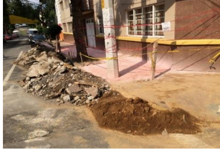
Figura 1. Residuos de Construcción almacenados incorrectamente
